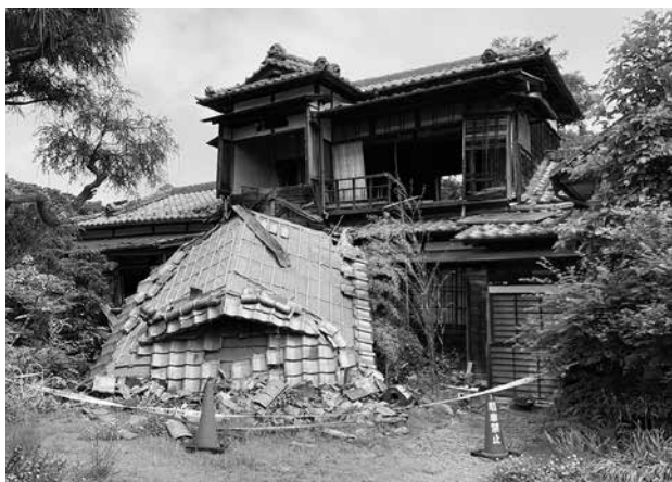
【写真1】2022年福島県沖地震で全壊した鈴木家家屋
