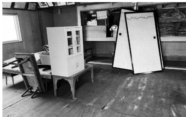
床上浸水被害のあった公民館
