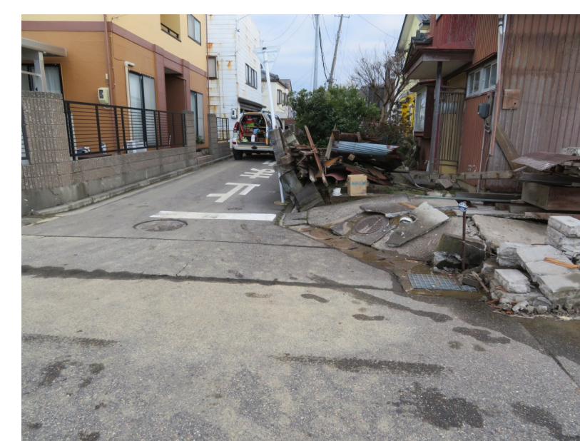
▲基礎崩壊により倒壊した家屋（小屋）
