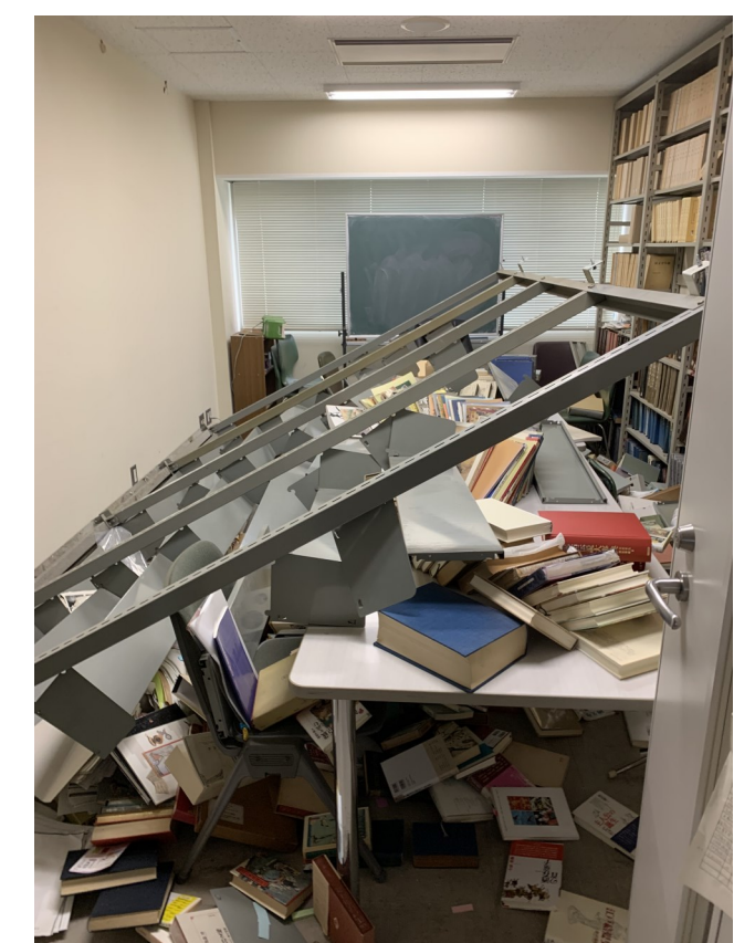
▲固定釘が抜け倒壊した書架（新潟大学）
