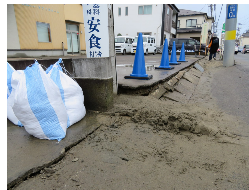
▲液状化現象による噴砂と沈降
