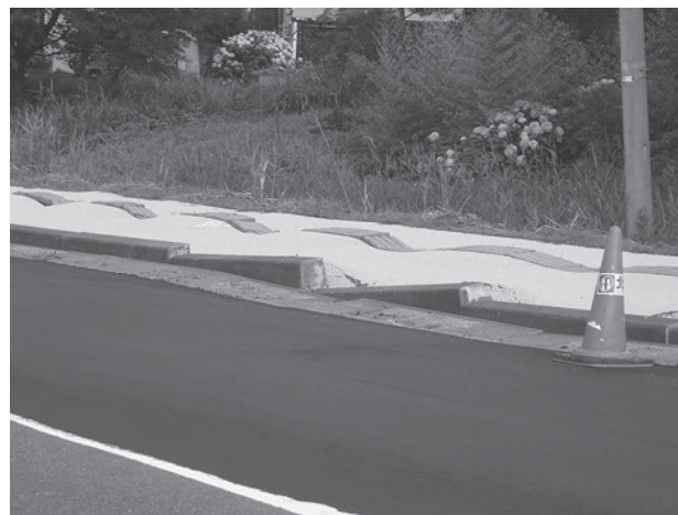
写真1 2007年7月19日柏崎の道路 波打つ歩道
